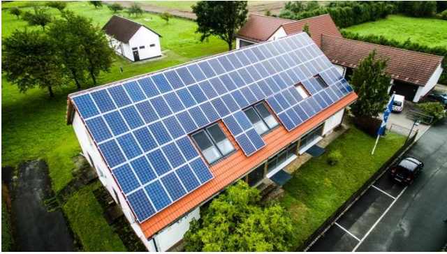
16 kWp Gemeindeverwaltung Rückersdorf
