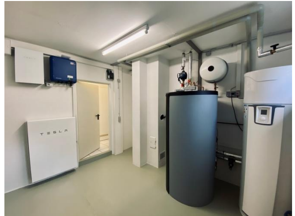
Heizraum inkl. 500 l Panasonic Trinkwasser Wärmepumpe
