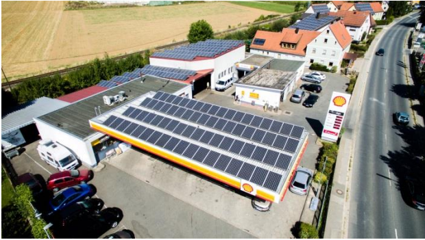
27 kWp Tankstelle Igensdorf
