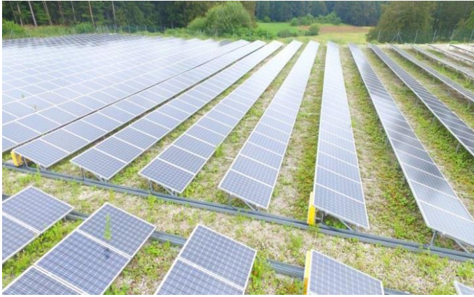
579 kWp Freilandanlage Betzenstein
