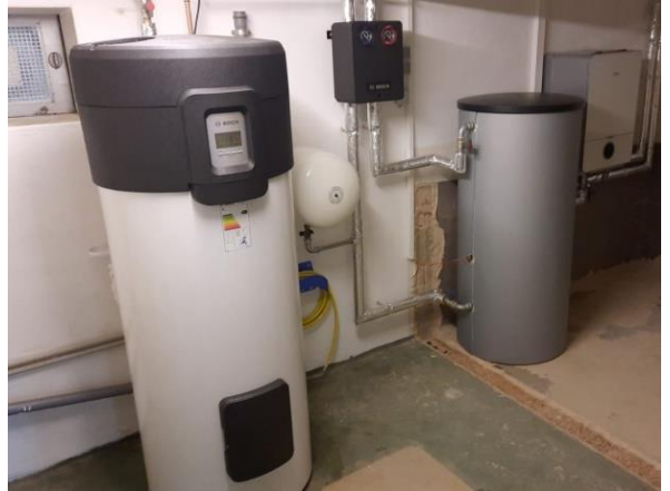
Bosch Trinkwasser Wärmepumpe inkl. 300 l Pufferspeicher
