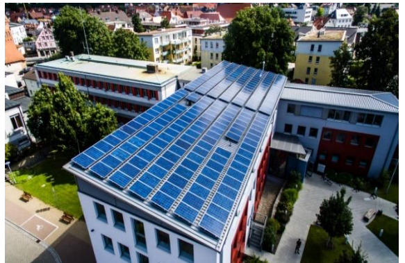
48 kWp Landratsamt Forchheim
