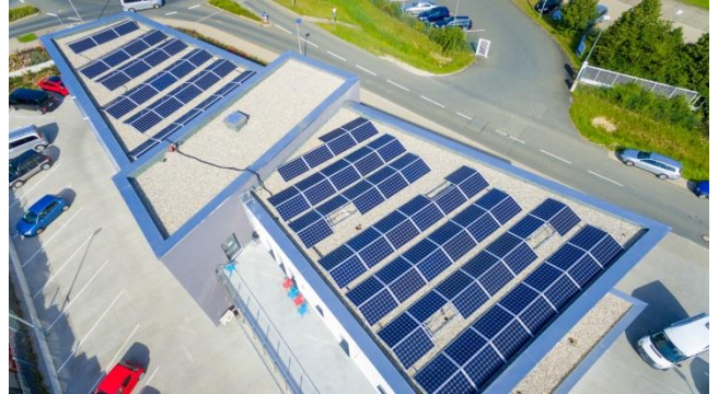
35 kWp Ärztelhaus Eckental
