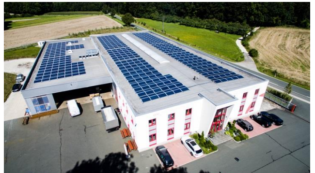
187 kWp Fertigungsfirma Haidhof
